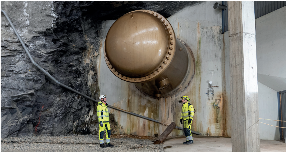
Bilde fra innsiden av dagens kraftstasjon. Tilløpsrøret på bildet er et av tiltakene som ble gjort da kraftverket ble bygget for å klargjøre for et eventuelt fremtidig aggregat 3. Alle tilløps- og avløpstueller, samt fjellhaller for elektroutstyr ble også klargjort da kraftverket ble bygget.
