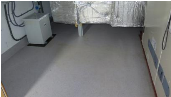
Foto 9. Lekkasjemerker på gulv i ventilasjonsrom. Aggregatrom over gymsal.
