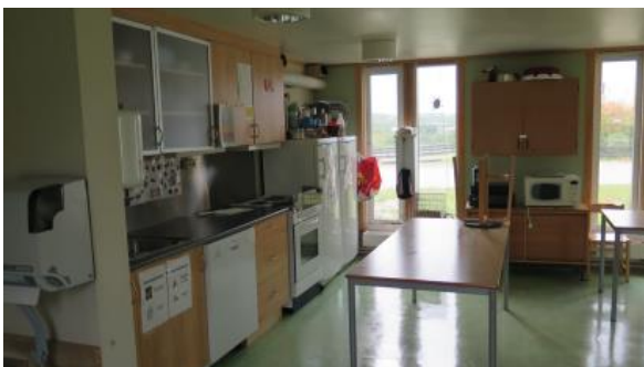
Foto 5. SFO-kjøkken. Taklekkasjer og skader på himlingen i rommet.
