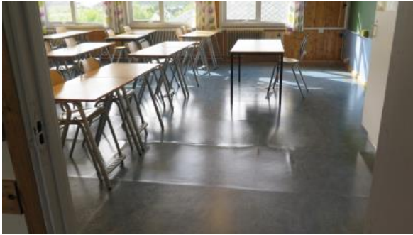
Foto 7. Klasserom B-205. Ujevnt gulvbelegg med oppsprekking i skjøter.
