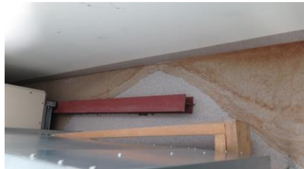
Foto 10. Fuktmerker på gulv inn mot vegg i ventilasjonsrom over gymsal.
