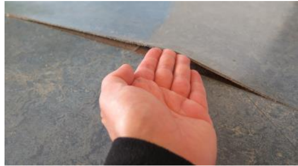
Foto 8. Klasserom B-205. Ujevnt gulvbelegg med oppsprekking i skjøter.
