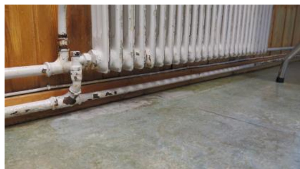
Foto 12. Lekkasje fra radiator, B-102.
